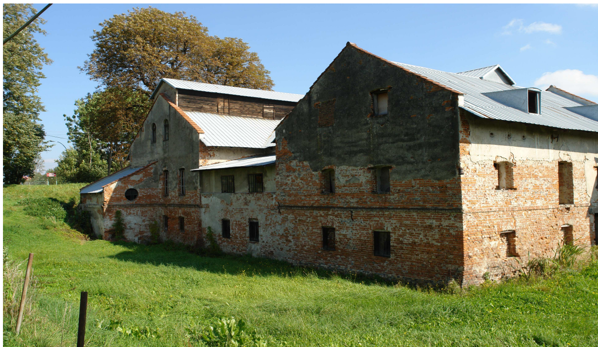
Fot. 8. Młyn Wodny w Boguchwale; widok od strony południowo – wschodniej w kierunku ul. Cichej 23
