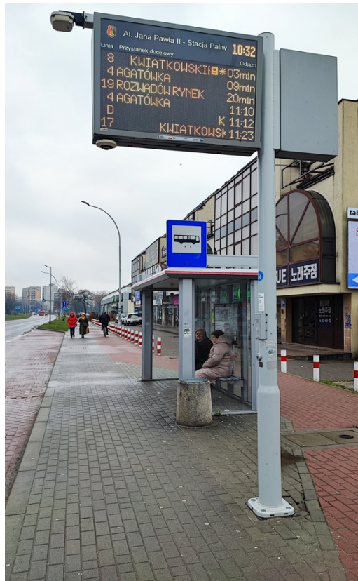
Rys. 11.1 Tablica przystankowa Dynamicznej Informacji Przystankowej w Stalowej Woli
